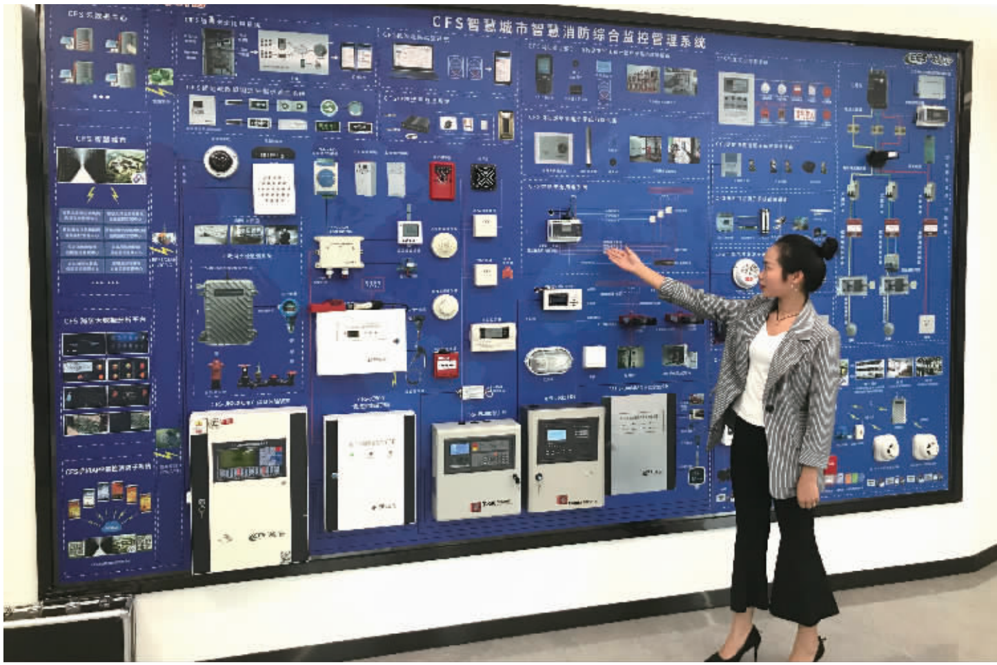
工作人员讲解智慧消防综合监控系统工作流程。
