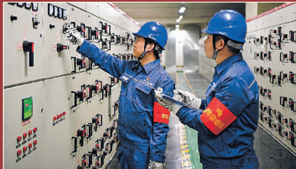
▲南方电网贵阳供电局城南分局运检四班班长刘进(左)和同事在巡检。
