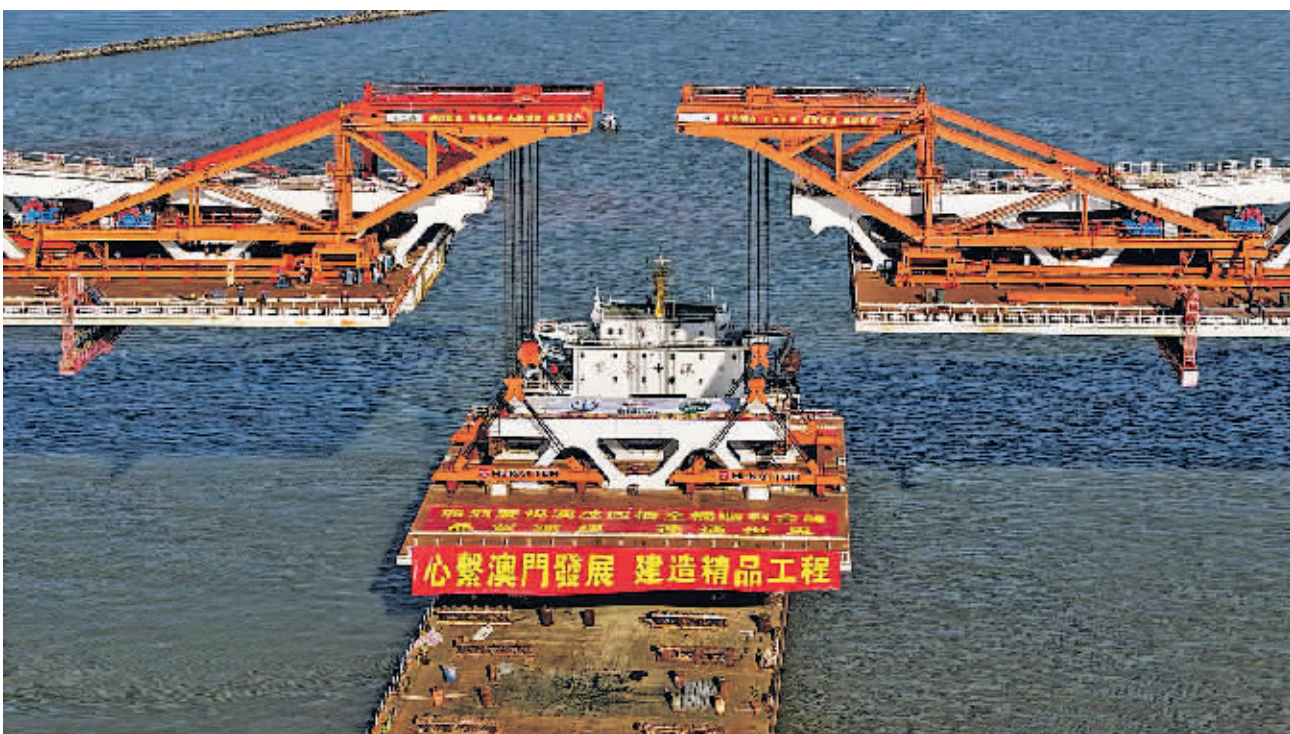
3月12日拍摄的澳门半岛至氹仔的第四条跨海大桥。 新华/传真
