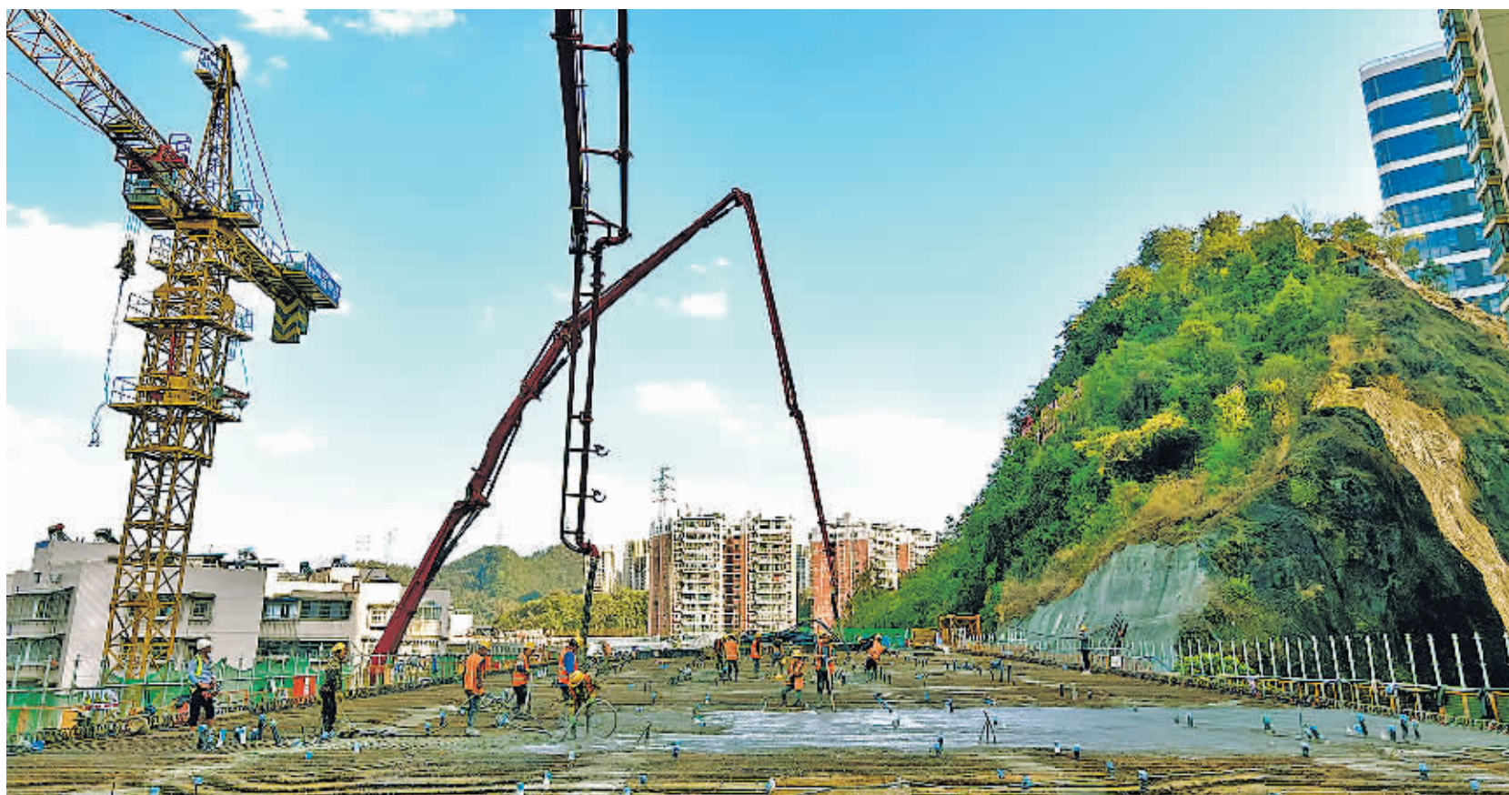
太慈桥高架桥14号至17号墩顶应力混凝土现浇梁施工现场。中铁八局三公司/供图
