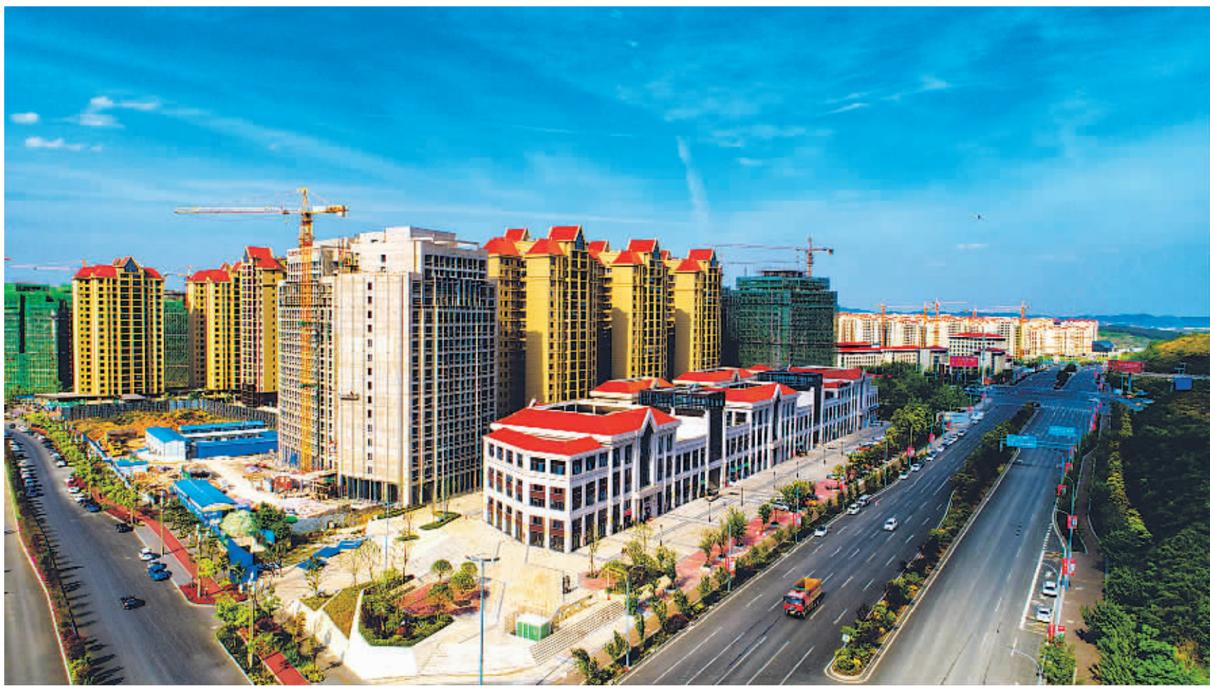
位于天河潭大道与百马大道交汇处的一个城市综合体项目正在加紧建设。
