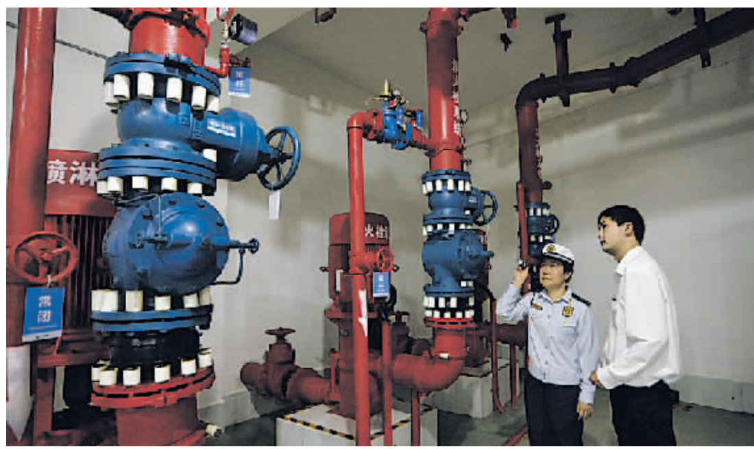
南明区消防救援大队消防监督员与山水黔城小区消防专员一道调试检查消防物联网设备。
